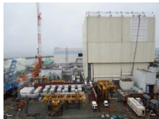
福島第一 1号機の原子炉建屋のカバー (放射性物質飛散防止用)
