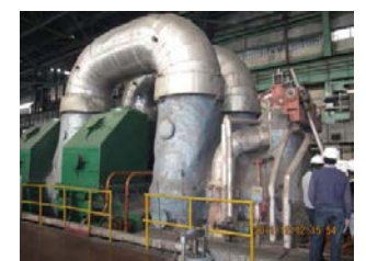
インド：ロシア製 21 万 kW タービン診断風景
